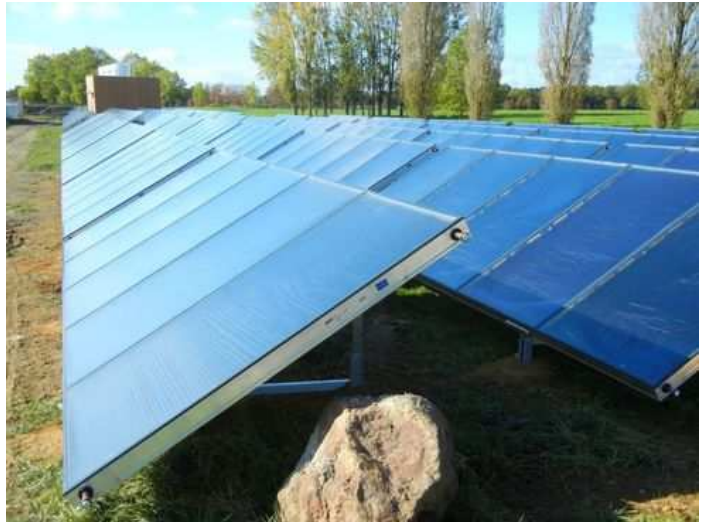
La centrale solaire thermique raccordée au réseau de chaleur avec chaudière bois et cogénération à Châteaubriant
