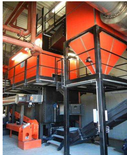
Chaudière bois collective à Châteaubriant
