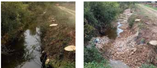
Ruisseau du Pas Guillaume (après abattage de peupliers) avant et après travaux morphologie (Derval 44)
