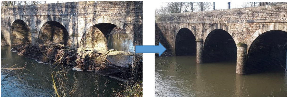
Embâcle sous le pont de la RD53 au lieu-dit « Bas Germigné » sur la commune d'Ercé en Lamée (35)
